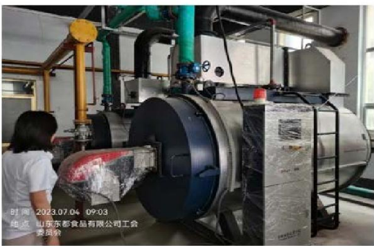
方快燃气锅炉 2 台
